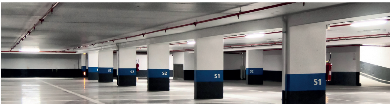
Exemple d'utilisation : éclairage d'un garage souterrain avec des tubes ISOLED® T8 Highline
